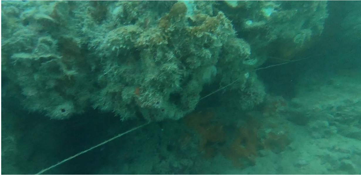
Εικόνα 2.17 Υποσκαφή στην υπήνεμη πλευρά του μώλου [Θέση: Θ12Α]
