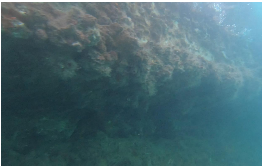
Εικόνα 2.18 Εσοχή κοντά στην ίσαλο στην υπήνεμη πλευρά του μώλου [Θέση: Θ12Β]
