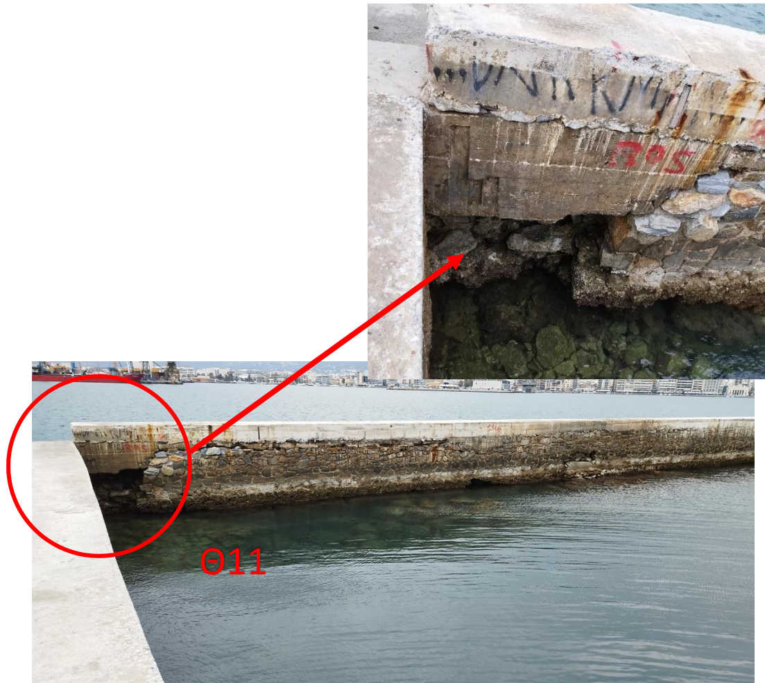
Εικόνα 2.16 Φθορές στο προστατευτικό τοίχιο (προσήνεμη πλευρά) [Θέση: Θ11]
