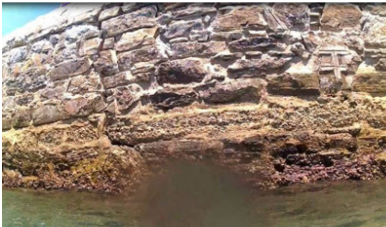
Φωτ. 2-9 Κατακόρυφη ρωγμή στο προφυλακτήριο τοιχίο, στην θέση 45μ. από αρχής (περίπου)
