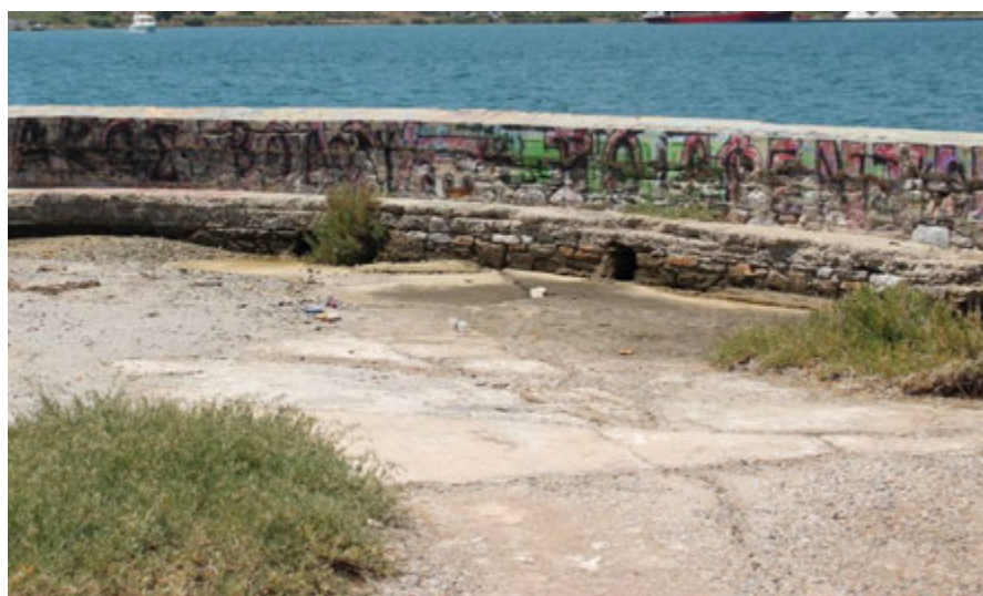
Φωτ. 2-7 Συνεχής ρωγμή επί των χερσαίων χώρων που καταλήγει στο τοίχιο
