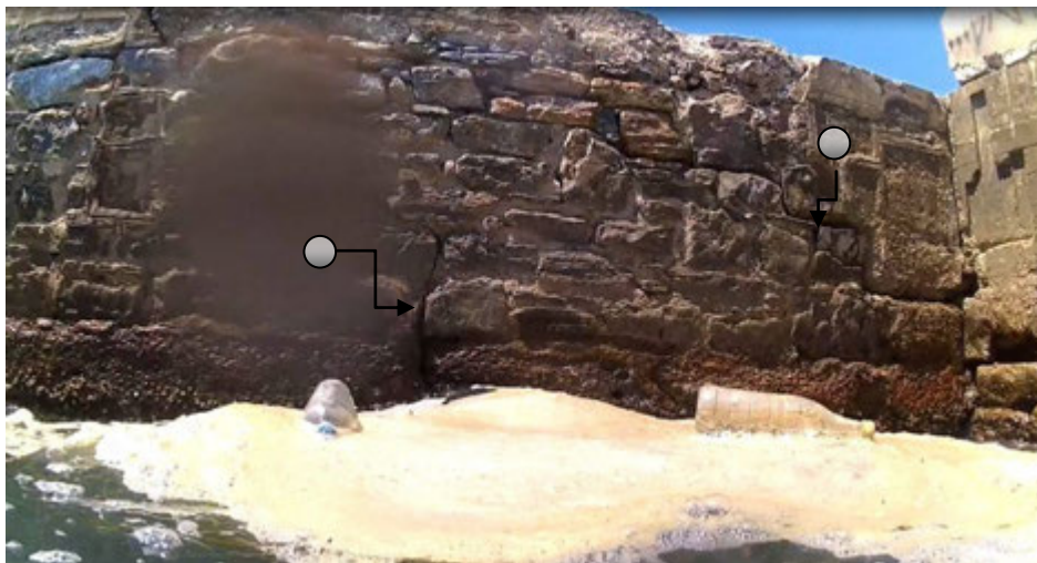
Φωτ. 2-14 Διαμπερείς κατακόρυφες ρωγμές στο προφυλακτήριο τοίχιο.
