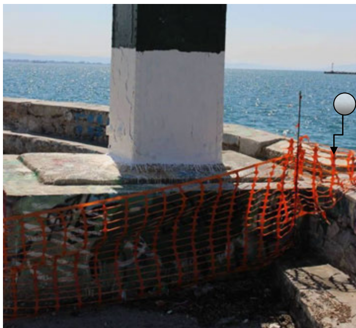
Φωτ. 2-8 Τμήμα τοίχου που έχει αποκολληθεί έμπροσθεν του φάρου
