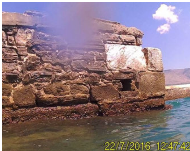
Φωτ. 2-11 Διαμπερής ρωγμή αμέσως προ της γωνιακής στήλης – άποψη της δόμησης του λιθόδομητου τοιχείου στο σημείο Δ
