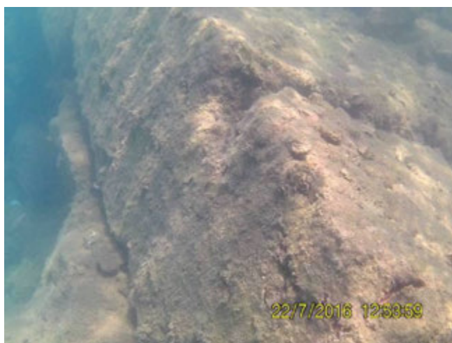
Φωτ. 2-4 Υποθαλάσσια άποψη των τεχνητών ογκολίθων του καταρρεύσαντος τμήματος
