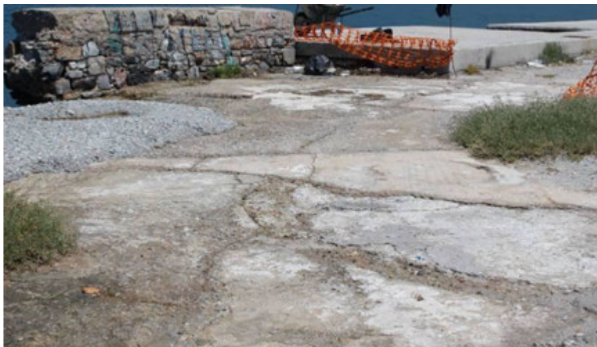
Φωτ. 2-6 Συνεχής ρωγμή επί των χερσαίων χώρων
