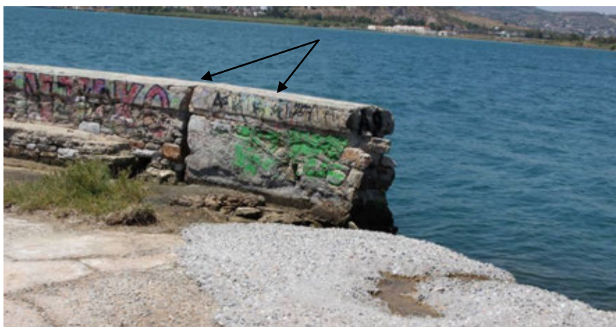
Φωτ. 2-5 Τμήμα τοιχίου υπό κατάρρευση
